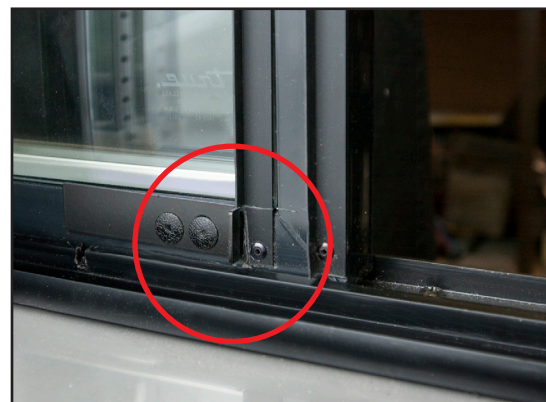
Рис. 2. Защелка двери в закрытом положении (не зафиксирована)
